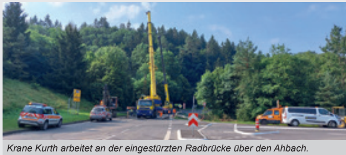
Krane Kurth arbeitet an der eingestürzten Radbrücke über den Ahbach.
