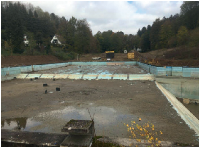
Ehem. Freibadgeländer vorher
